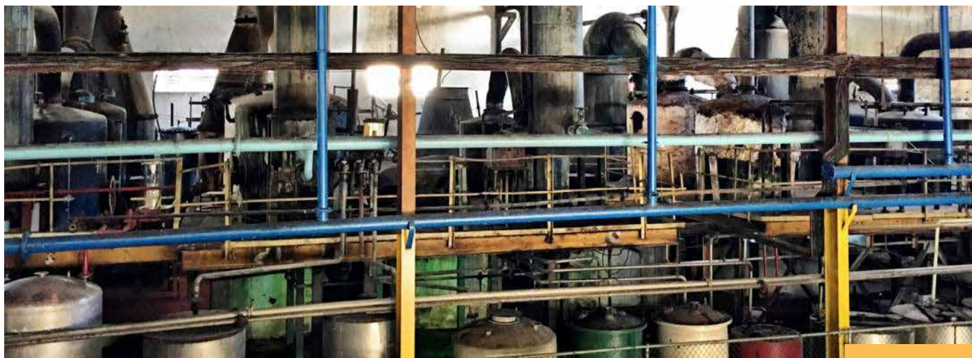
DESTILERÍAS INSTALACIONES DE LONG POND.
